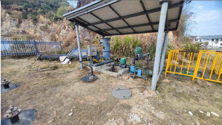
废水处理设施
