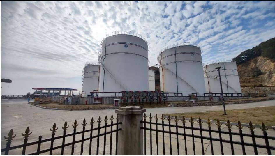
油品储罐区、发料台
