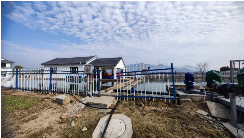
消防水池、消防泡沫储罐
