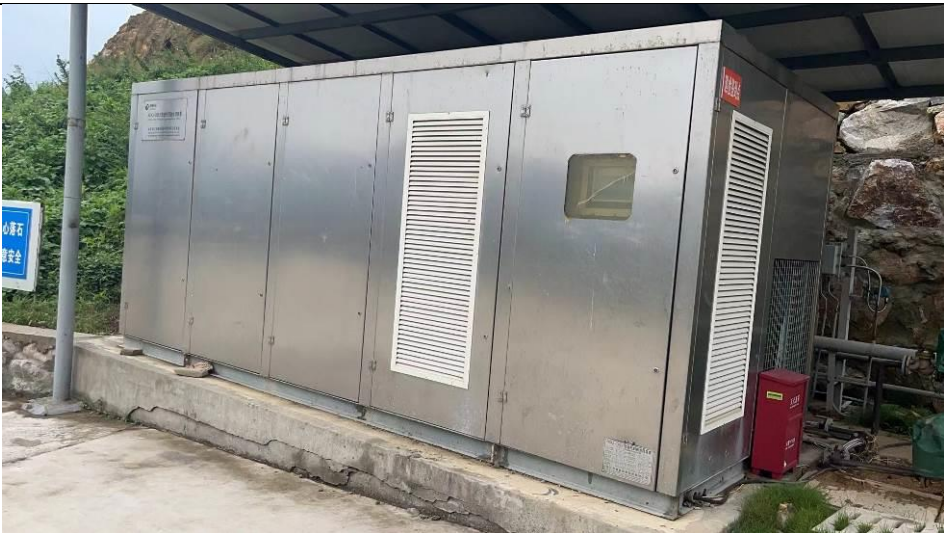
油气处理装置
