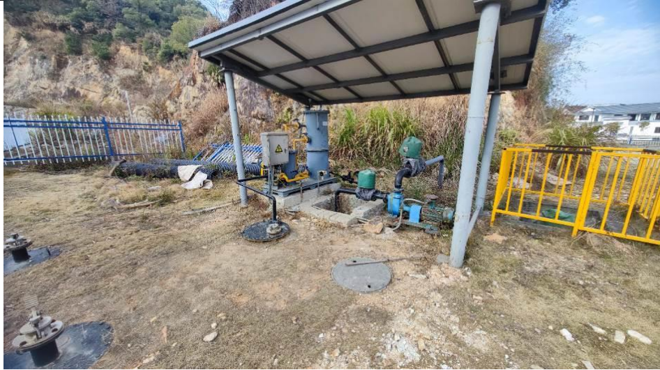
废水处理设施
