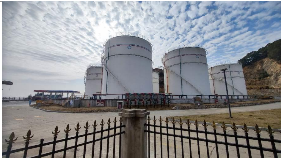
油品储罐区、发料台
