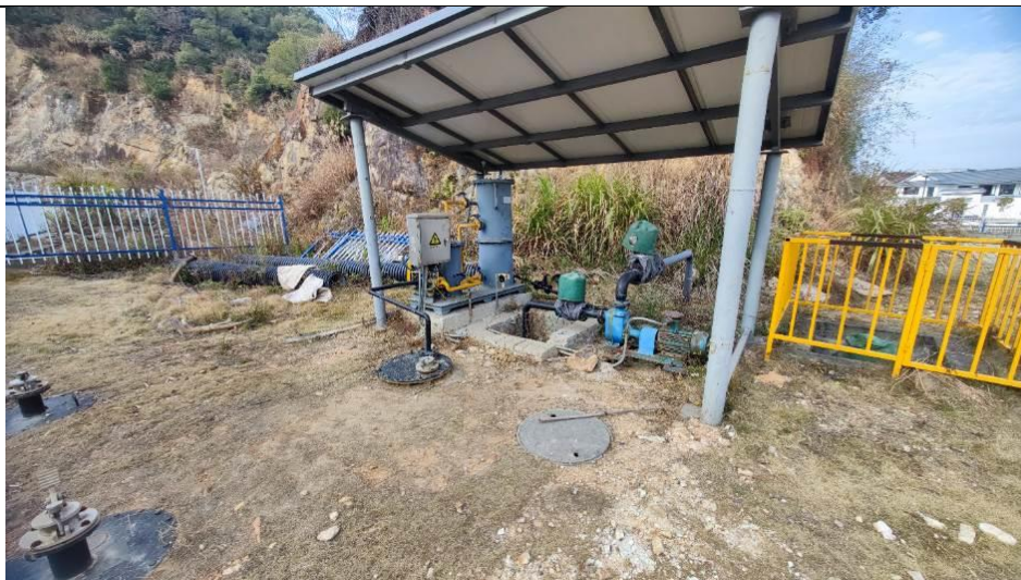
废水处理设施
