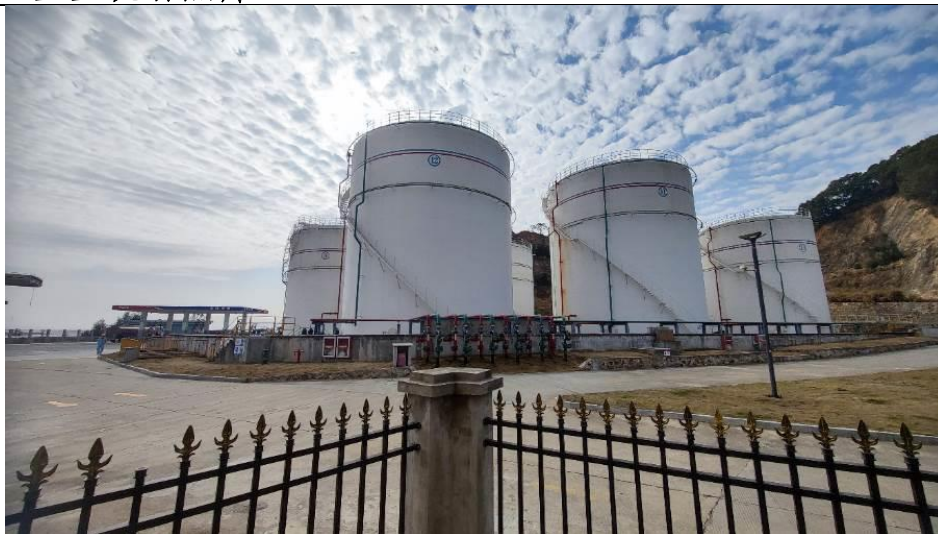
油品储罐区、发料台
