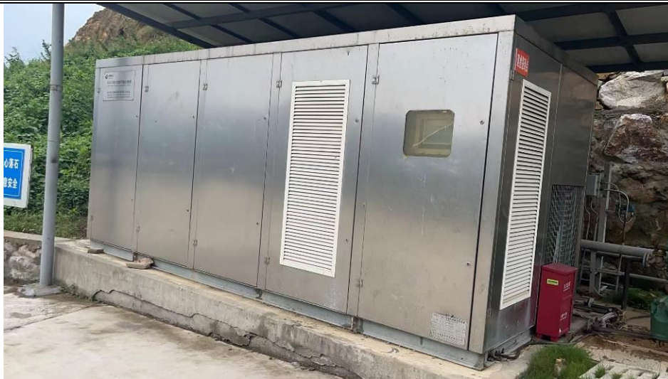
油气处理装置
