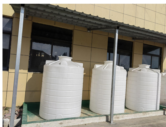
事故应急桶（重点防渗区）
