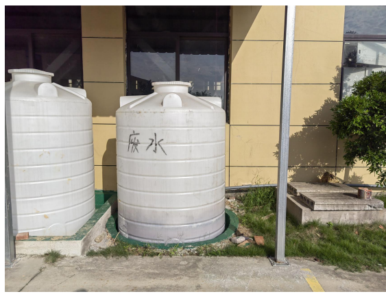
超声波清洗废水暂存储罐
