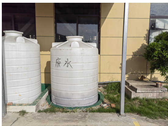
生产废水储罐区（重点防渗区）
