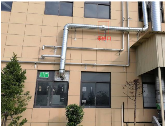
DA003 柴油燃烧废气排放口
