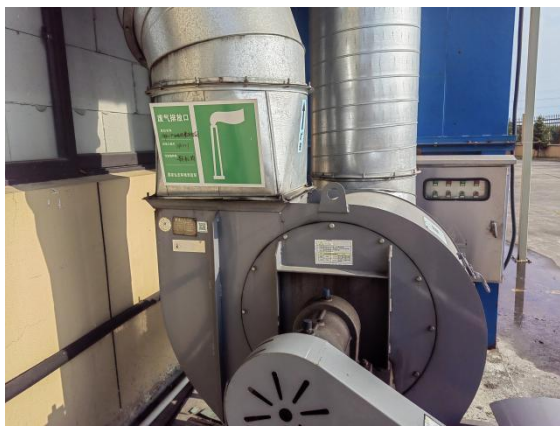
DA001 熔化扒渣保温烟尘排放口
