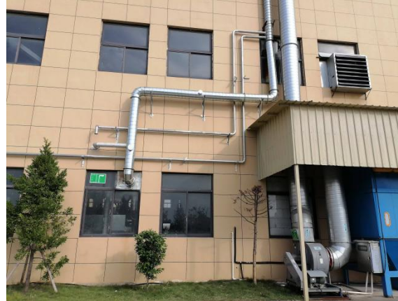
柴油燃烧废气排气筒 (DA003)
