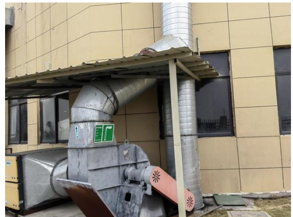
DA002 压铸脱模废气排放口
