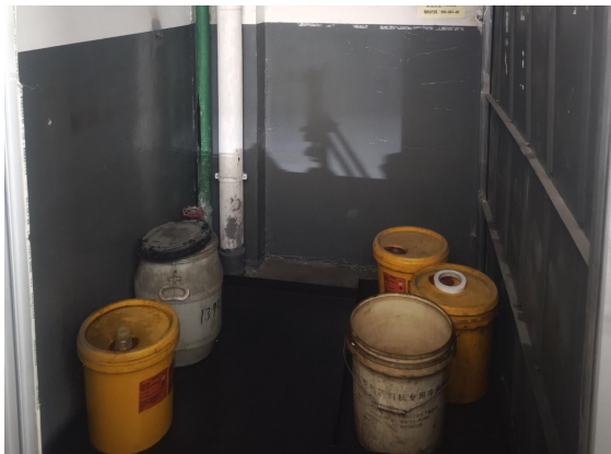
危废暂存间（重点防渗区）
