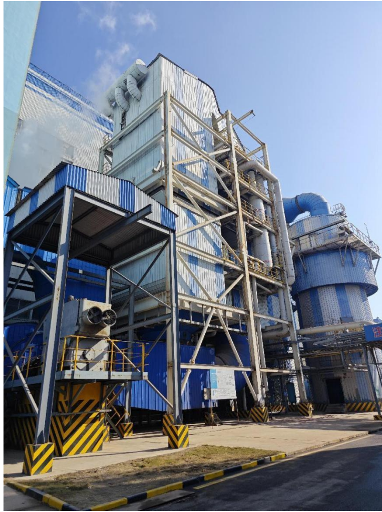
废气处理设施
