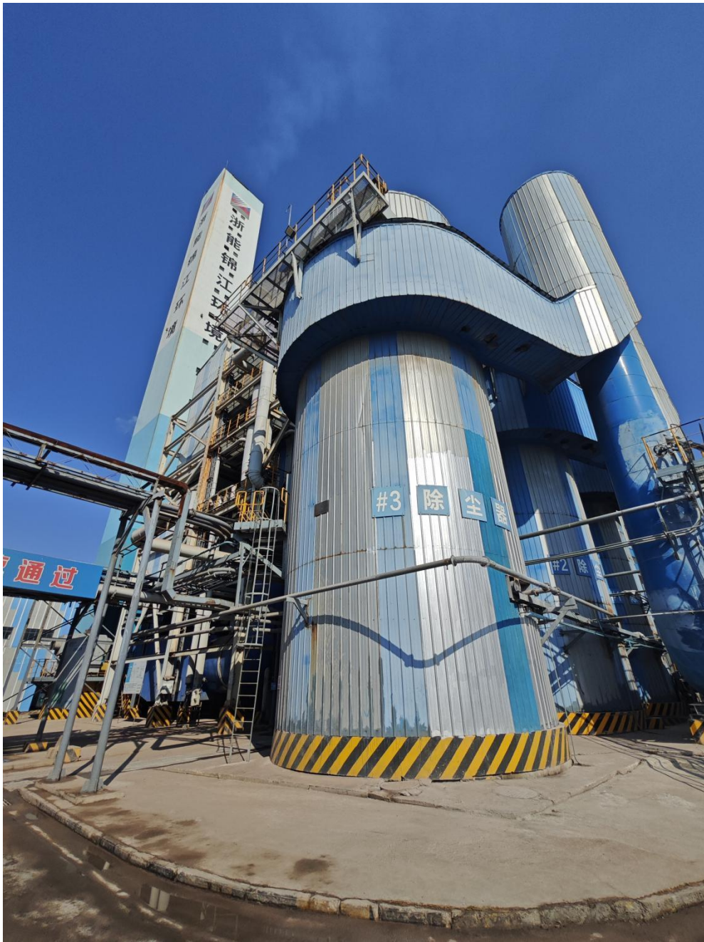
废气处理设施
