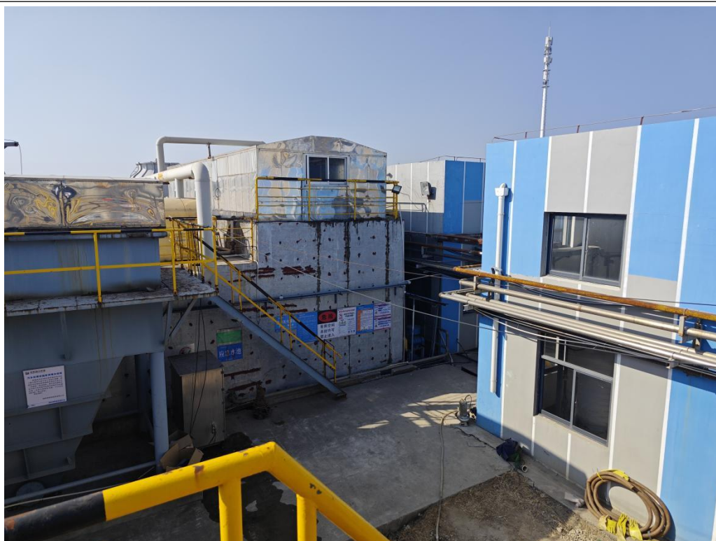
废水处理站管道收集
