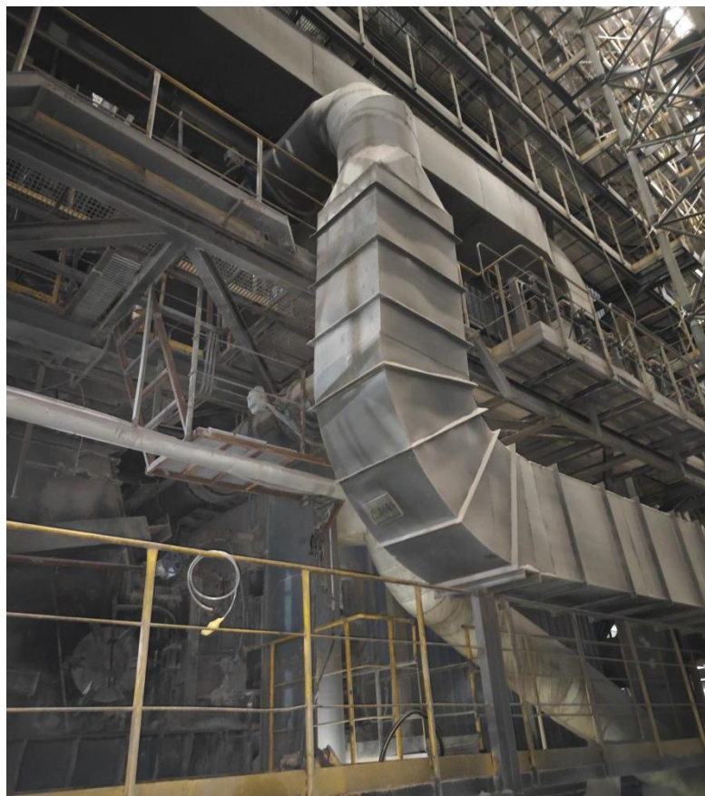
废气收集等管道
