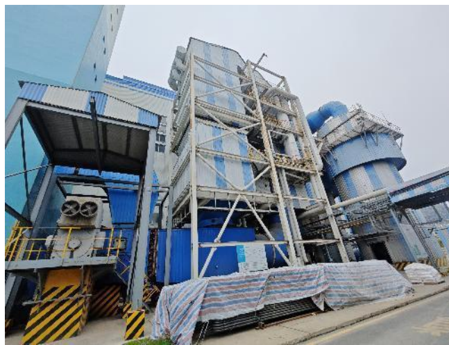
焚烧炉废气处理装置
