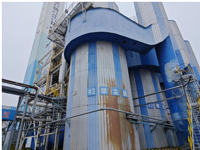
焚烧炉废气处理装置
