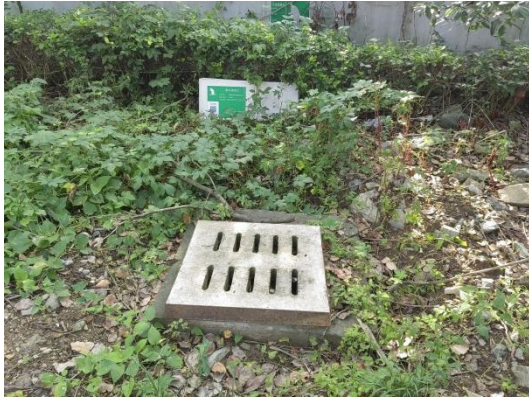
DW001 生活污水排放口
