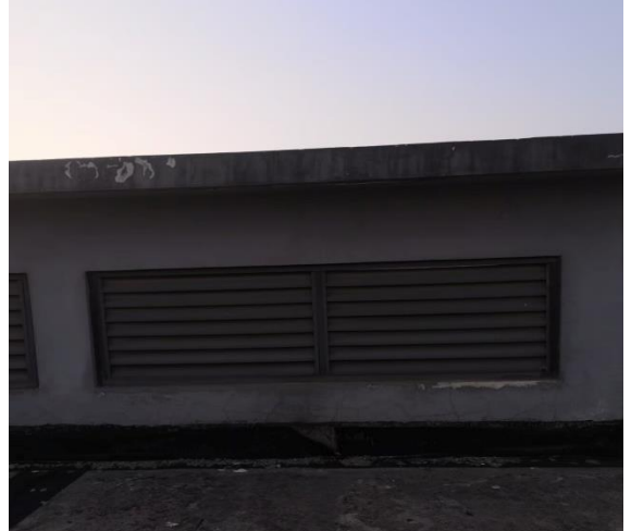
地下车库通风竖井
