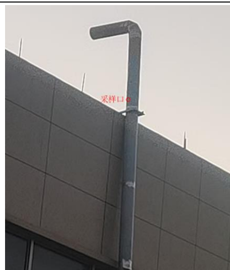
烘箱废气排放口 (DA006)
