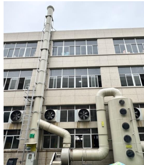
喷淋塔除尘器 (DA001)
