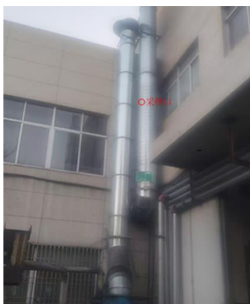
焊接废气排口(DA005)
