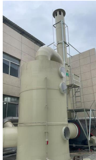
喷淋塔除尘器 (DA003)
