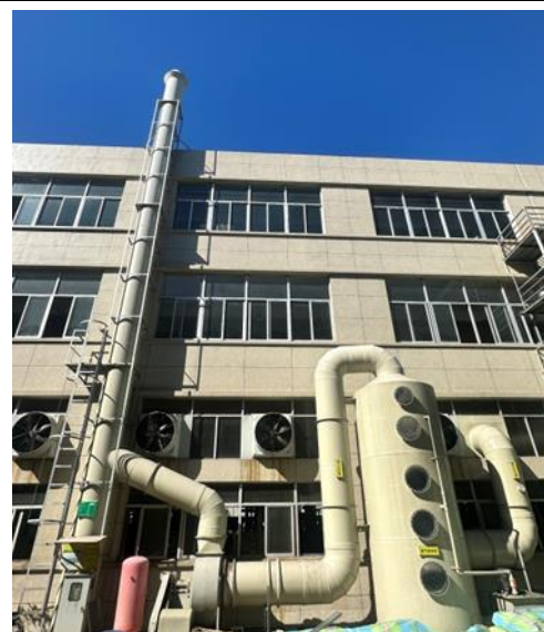
喷淋塔除尘器 (DA002)
