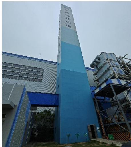
焚烧废气排气筒
