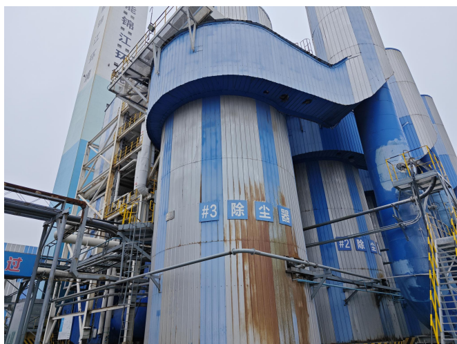
焚烧炉废气处理装置
