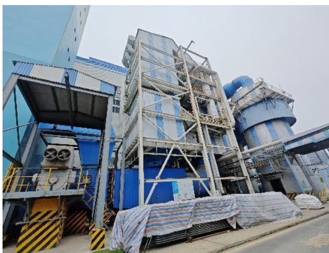
焚烧炉废气处理装置
