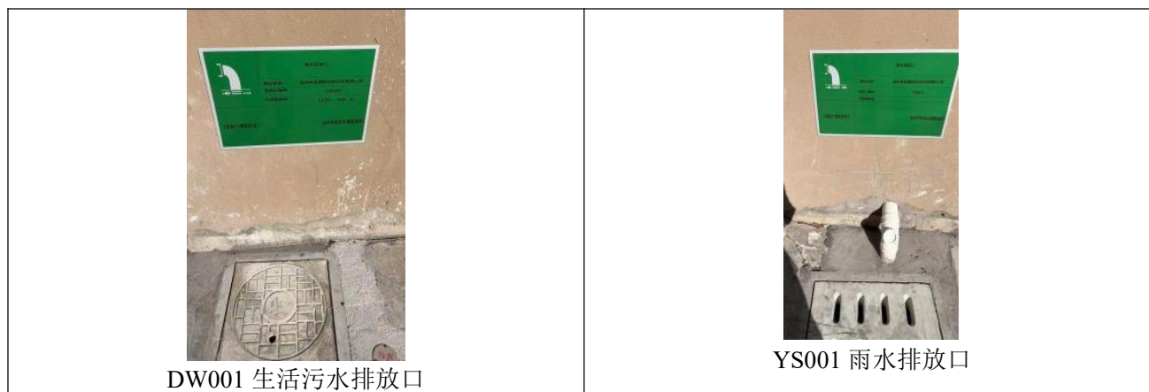
图 3-4 项目废水排放口设置情况
