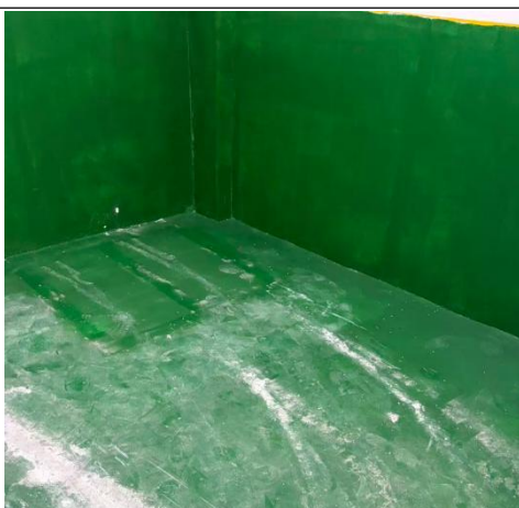
危废暂存间（重点防渗区）
