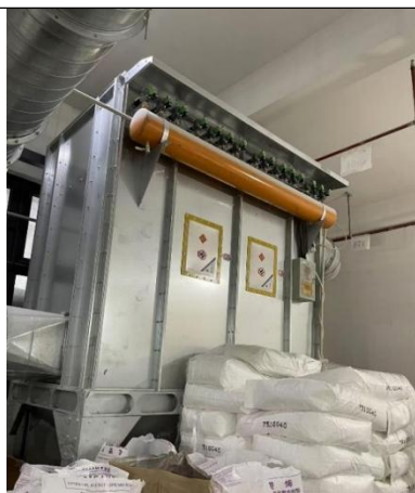
投料、密炼、开炼、造粒废气除尘设施（DA002）
